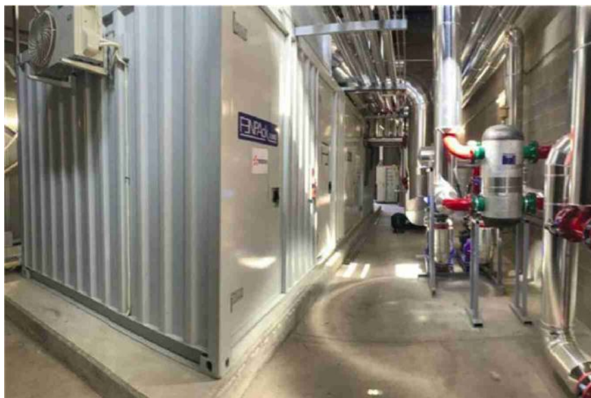
L'impianto di cogenerazione che è stato installato, collaudato e attivato all'ospedale cittadino
